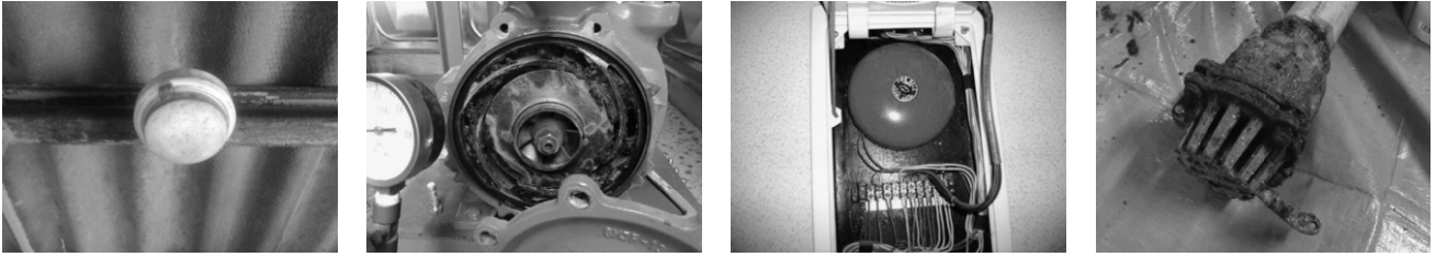
経年劣化により不具合が発生した消防用設備等の事例
