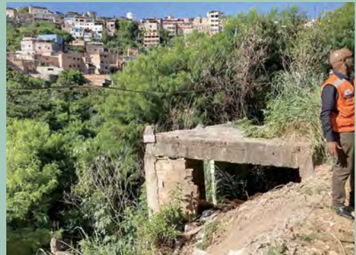
写真5 大雨で違法住宅が崩壊し犠牲者が出た現場、市民防衛組織の取組みも困難
