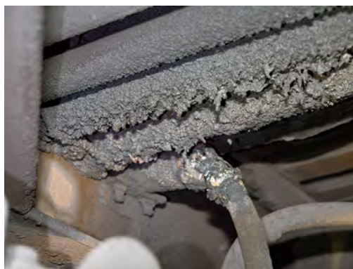
写真6 出火箇所の拡大
