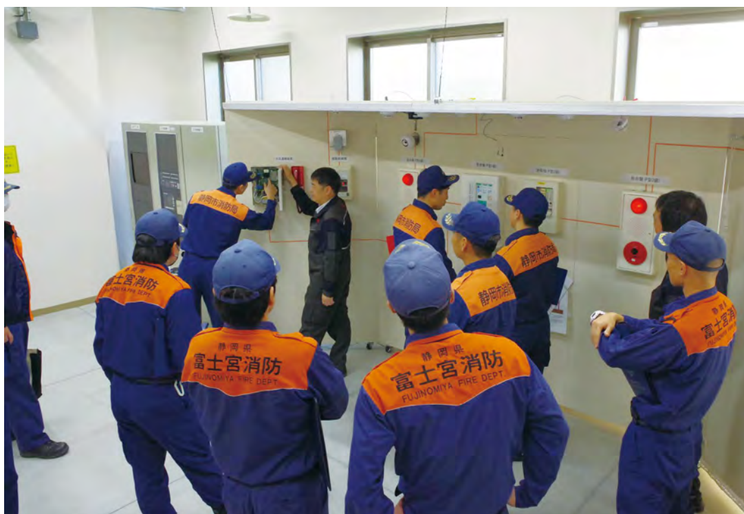
研修施設内に設置された消防用設備等
