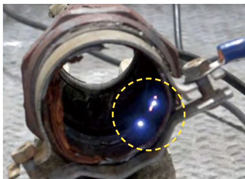
写真11 通電試験による火花放電の状況
