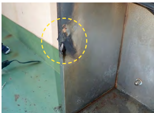
写真3 低圧用プルボックス内の状況
