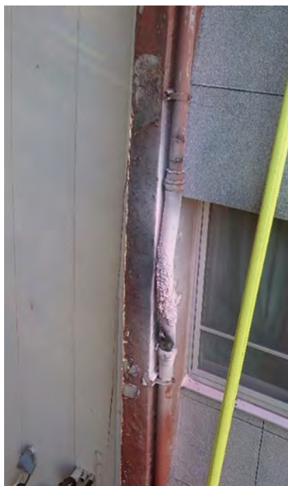
写真2 焼損した高圧ケーブル
