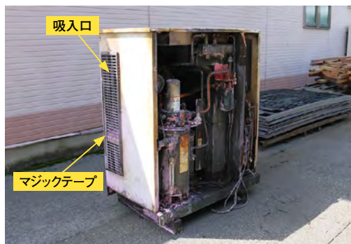
焼損したコンプレッサの外観
