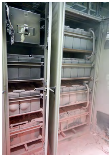
焼損したキュービクルの状況
