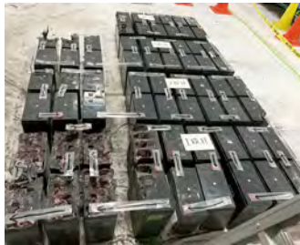
取り外したバッテリーの焼損状況
