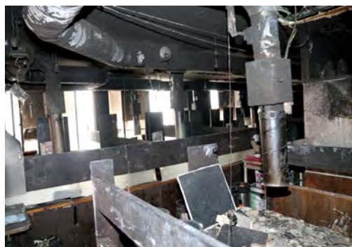
写真1 上引き排気ダクト火災の事例
