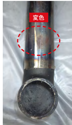
縦ダクトの変色
