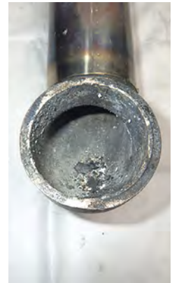
縦ダクト下部エルボ内の炭化 及び灰化物
