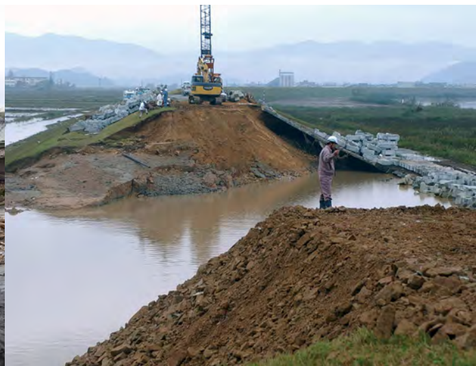
写真4 2004年台風23号による円山川の堤防決壊現場 (撮影・時事通信社)
