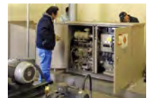
自家発電設備点検の様子
