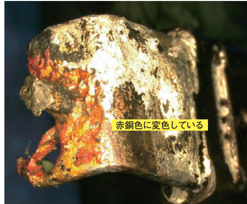
写真12 焼損品一端子(ダイオード素子側)
