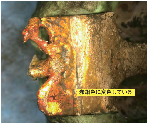
写真11 焼損品一端子(エポキシ樹脂側)
