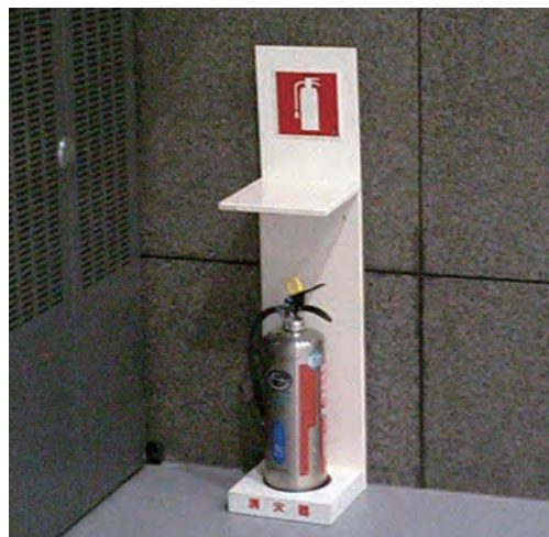
消火器のピクトグラムの設置例
