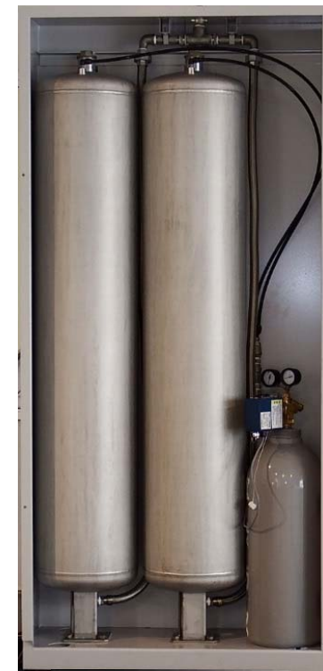
消火薬剤ユニット
