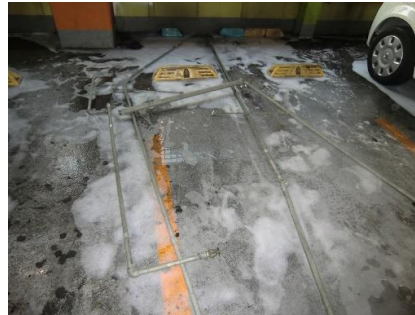
泡流出事故の例
