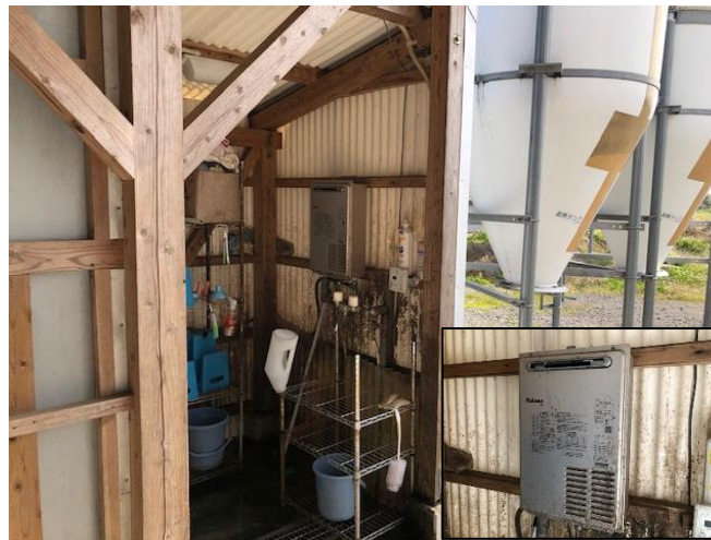
④給湯器の状況
