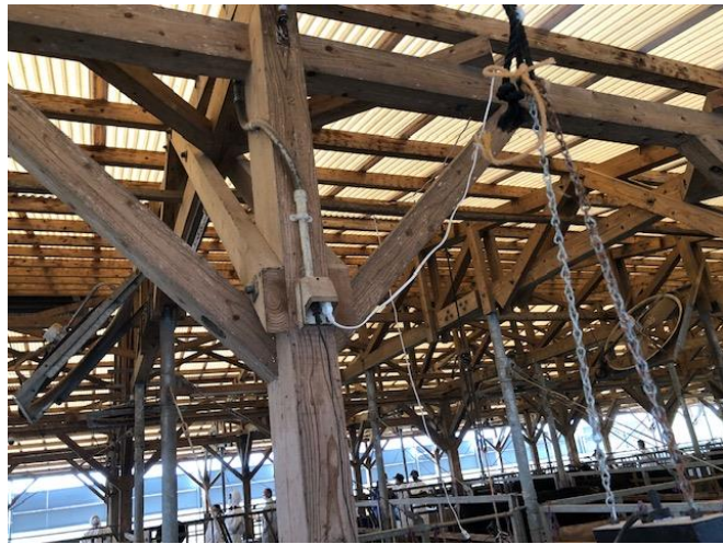
①電気配線の状況
