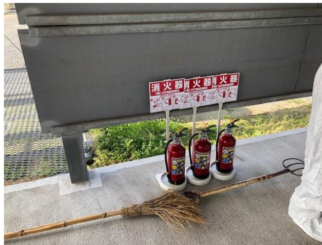
④消火器の設置状況
