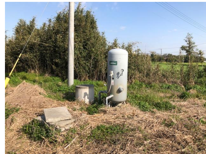
⑤地下水タンクの状況
