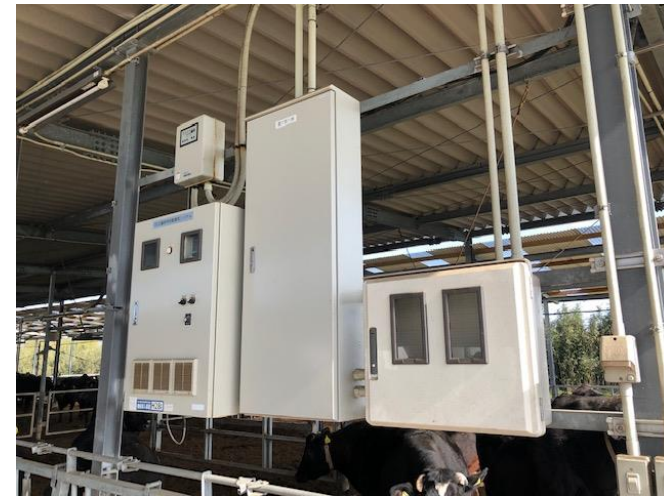
②分電盤の状況
