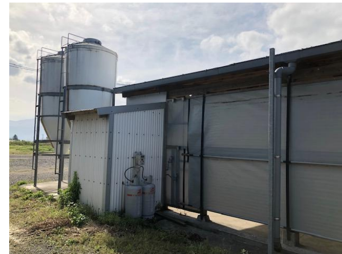
⑤LPG設置状況
