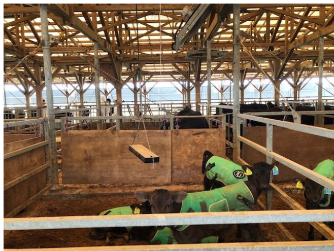
③電気ヒーターの状況
