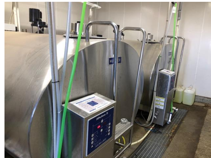
④生乳タンク室の様子
