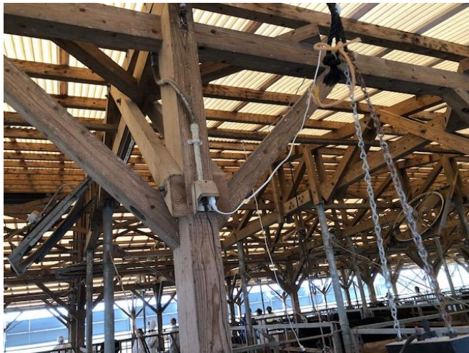
①電気配線の状況
