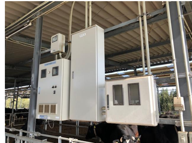
②分電盤の状況
