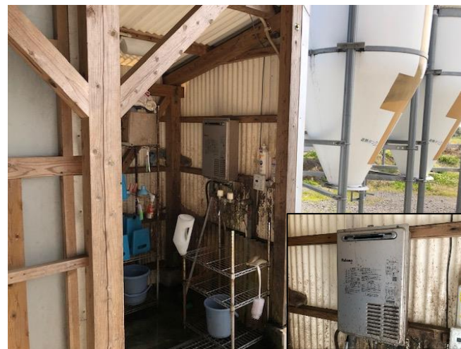
④給湯器の状況
