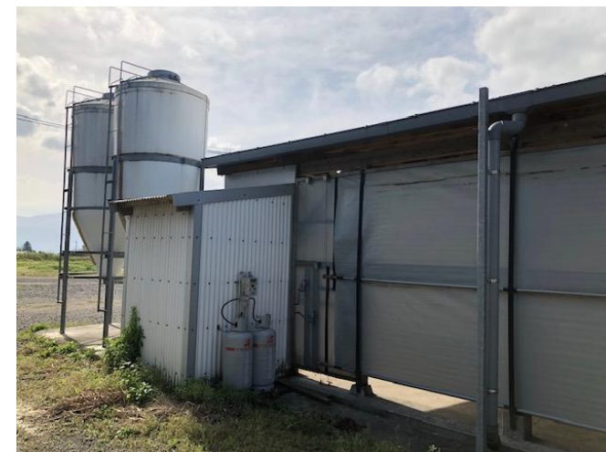
⑤LPG設置状況
