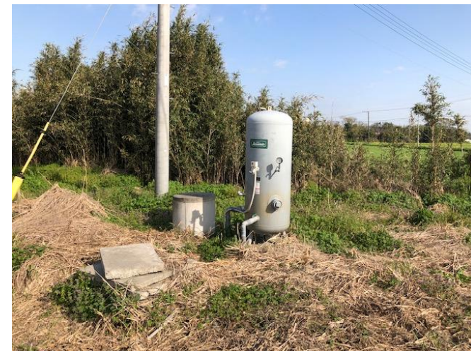
⑤地下水タンクの状況
