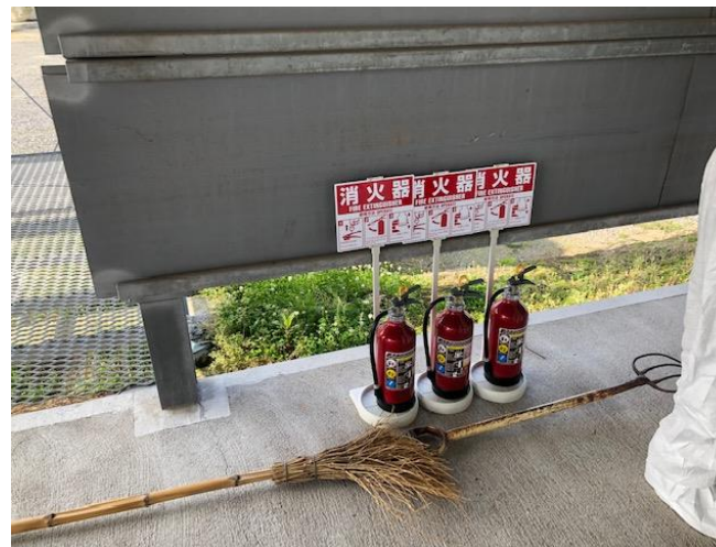
④消火器の設置状況
