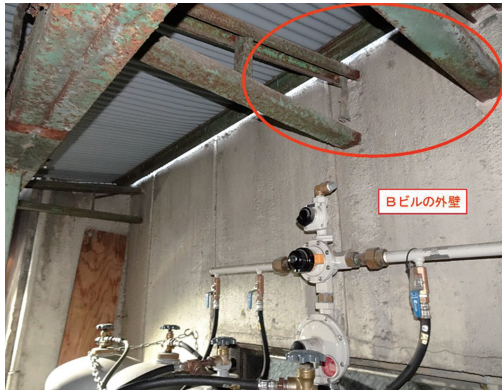
ガスボンベ庫内の状況
