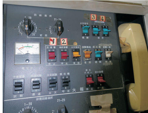
自動火災報知設備の受信機の状態
