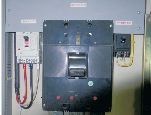
スプリンクラー設備のポンプ電源の状況
