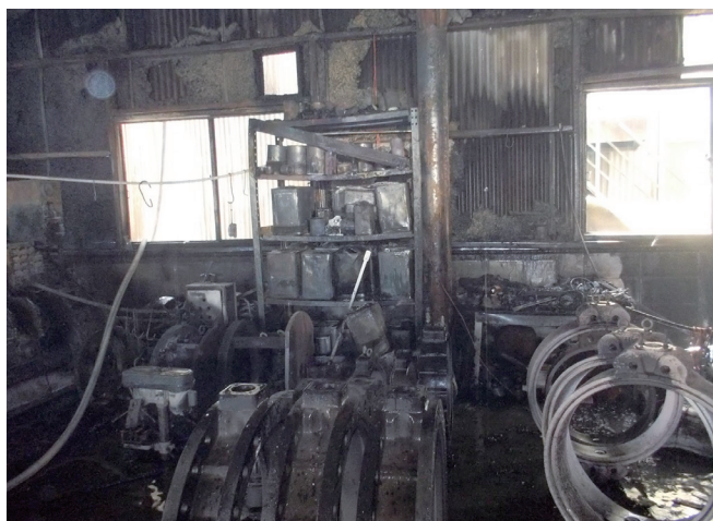
危険物存置の状況
