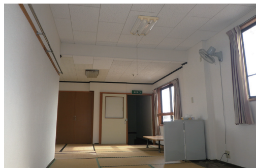
(5) 項イで木造、自火報未設置、避難器具未設置、特定一階段、堅穴区画未形成で3階の使用制限(法5条の2行使)
