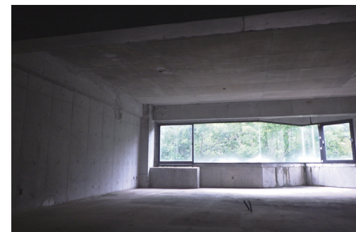
建築途中の建物を使用しており、警告前に是正
