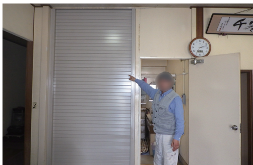
縦穴区画防火シャッター連動不備により常時閉鎖(法5条行使)
