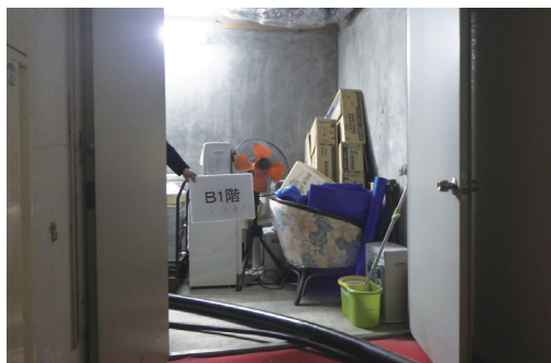
地階の屋内階段横の倉庫内に存置された物件に対する措置(写真下の黒い配管により区画が形成できないため、階段区画内と同一であると判断し法5条の3行使)
