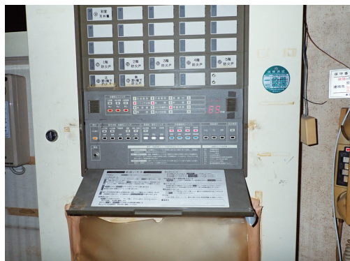
受信機(非常電源接続検査時)
