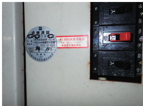
自動火災報知設備専用回線
