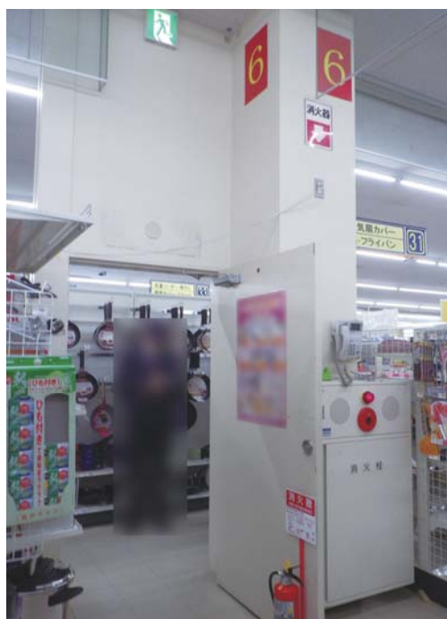
消火器を用いて開放している防火戸
