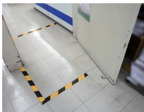
くさびを用いて開放している防火戸
