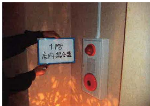
自動火災報知設備発信機等の設置状況
