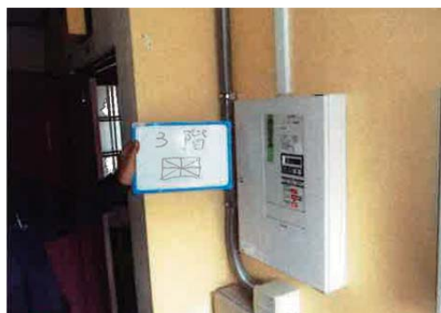
自動火災報知設備受信機の設置状況
