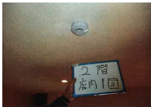
自動火災報知設備感知器の設置状況
