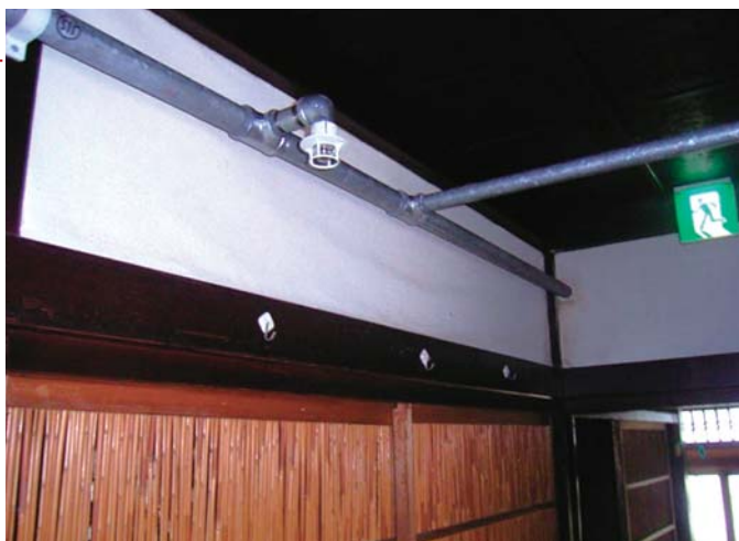
設置されたスプリンクラー設備
