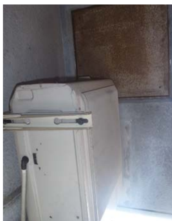
写真4 降下障害(クーラーの室外機が障害となり避難ハッチが開かない。)
