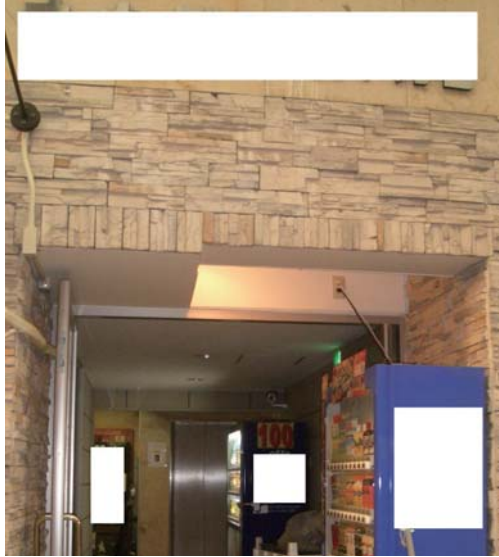
写真2 降下障害 (建物西側の避難ハッチ下に自動販売機が設置されている。)
