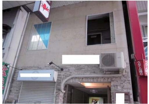
写真7 建物西面(連結送水管送水口障害のクーラー室外機移設)
