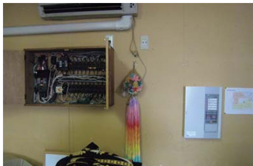
改善状況(自動火災報知設備)
