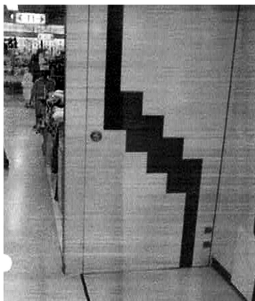
平成22年7月21日警告書交付後の確認の状況 防火扉の商品が除去され可動空間の明示がなされた。
