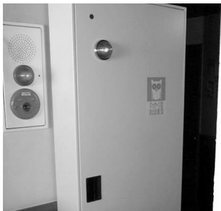
設置されたパッケージ型消火設備の外観
