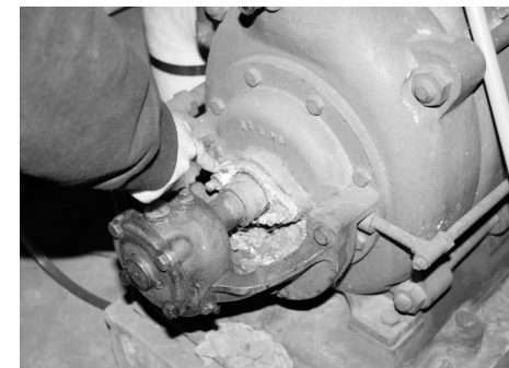
錆びついたモーター
