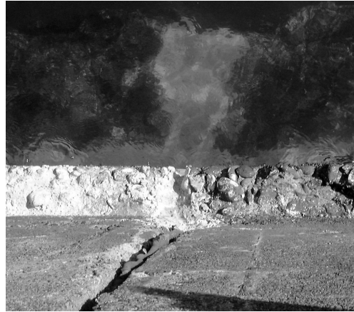
写真3 岸壁継ぎ目から流出する油
