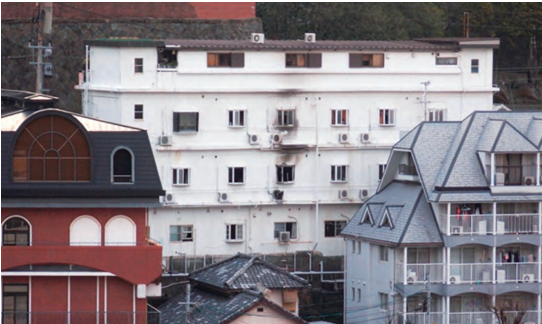
火災建物(中央白の建物)の外観
