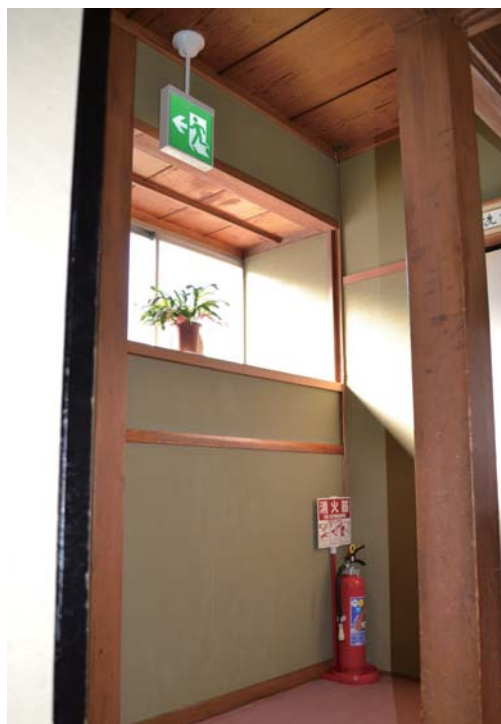
設置された誘導灯
