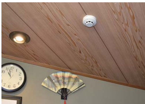
設置された自動火災報知設備の感知器
